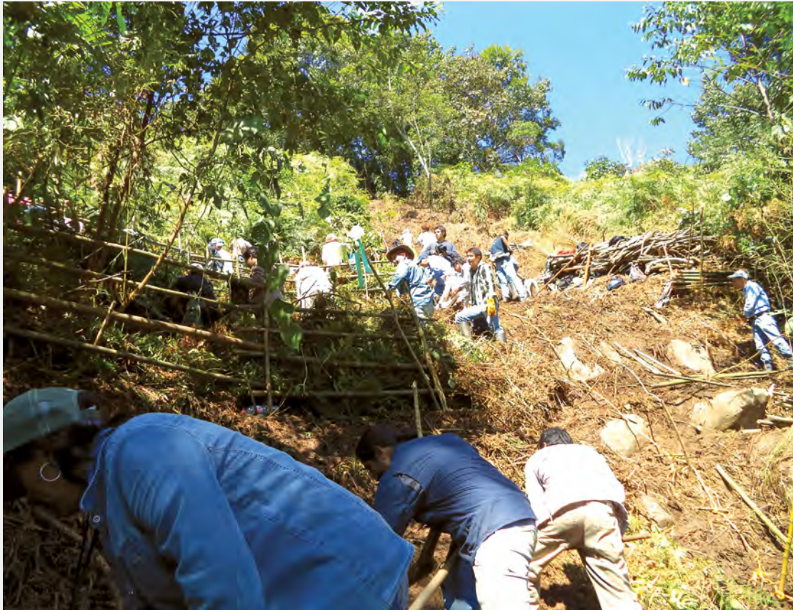
■ Figura 1. Labores de restauración en un área privada de conservación en Veracruz. Foto. Bernardino Villa.
